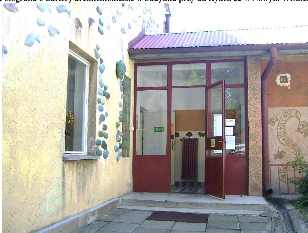
Fotografia 6 Bariery architektoniczne w budynku przy ul. Rynek 33 w Nowym Wiśniczu
